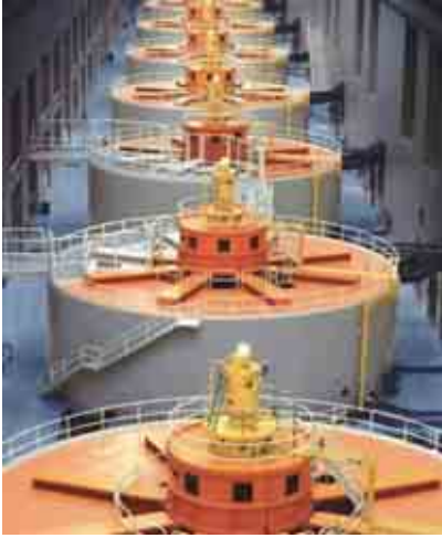
SES hidrogenatorları (fraqment)
